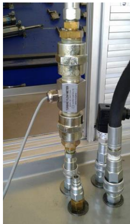
Figura 20-3: Instalación hidráulica del caudalímetro DGTT-015S
