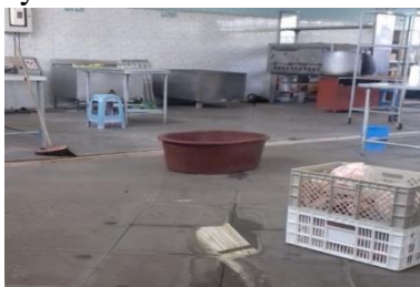
Figura 1-5. Gavetas y materiales obstaculizando las zonas de tránsito
