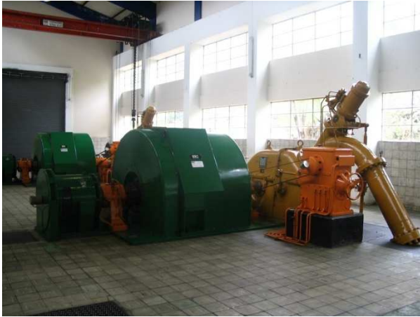
Figura 9. Turbina y Generador
