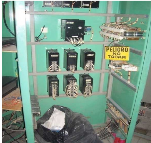
Figura 16. Señalización Limitada en Tableros de Control
