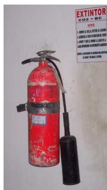
Figura 13. Extintor tipo (CO 2 )
