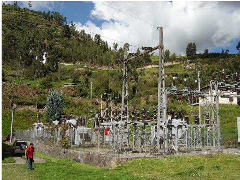
Figura 11. Sub estación Central Alao
