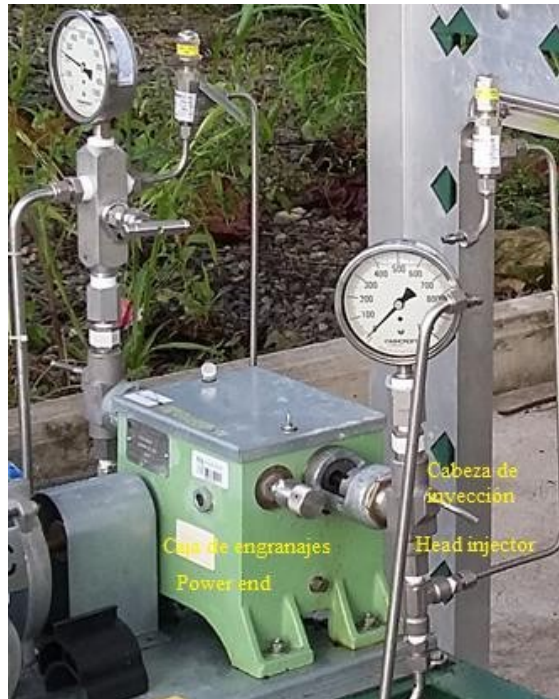
Figura 15-4: Bomba de inyección de químico Realizado por: Mancero, Ernesto, 2017
