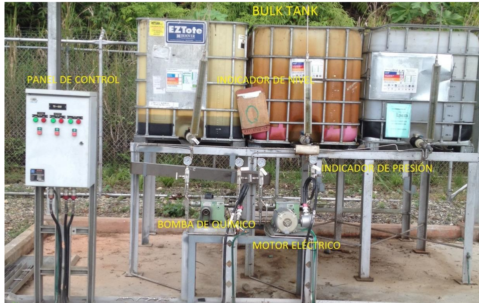
Figura 9-4: Componentes de un sistema de inyección de químico Realizado por: Mancero, Ernesto, 2017
