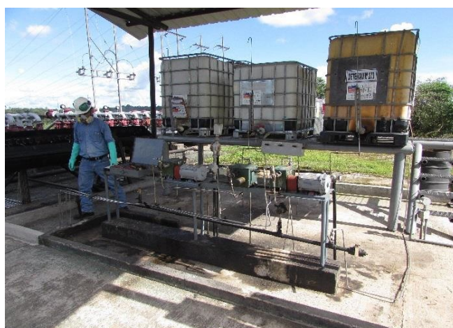
Figura 7-4: Sistema de inyección de Químico en Planta de Proceso Realizado por: Mancero, Ernesto, 2017
