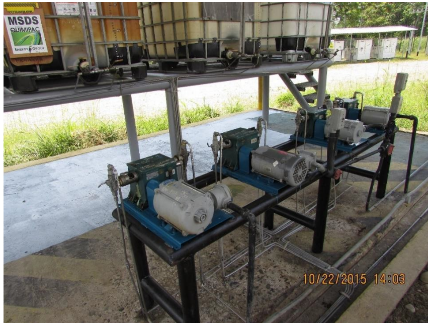
Figura 4-4: Sistema sin protección de Seguridad PSV & PI Realizado por: Mancero, Ernesto, 2017
