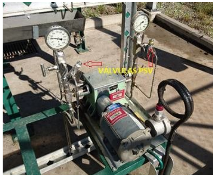
Figura 5-4: Sistema con protección de Seguridad PSV & PI Realizado por: Mancero, Ernesto, 2017
