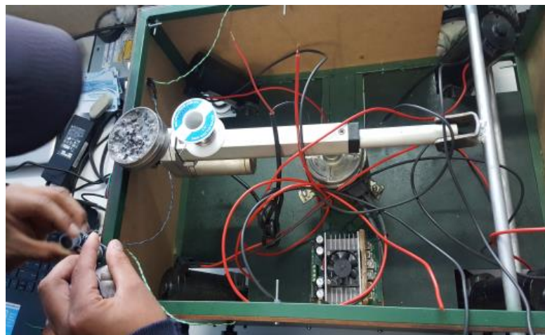
Figura 65- 2: Cableado de sistemas
