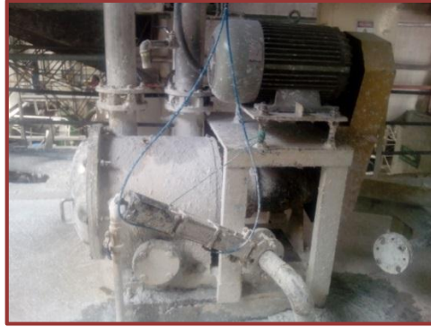
Figura 9-1: Equipo para depuración secundaria (Clasificador horizontal centrífugo).
