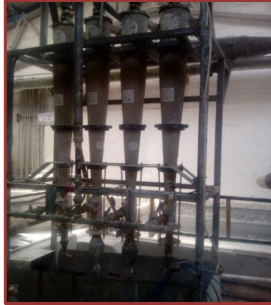
Figura 41-1: Equipo para limpieza 3 (Limpiadores de baja densidad).
