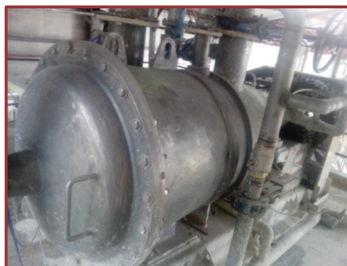
Figura 8-1: Equipo para depuración primaria (Depurador ADS).
