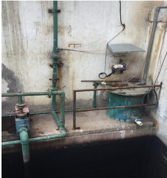
Fotografía 2-1: Tubería que conecta el tanque de homogenización y el tanque biológico.
