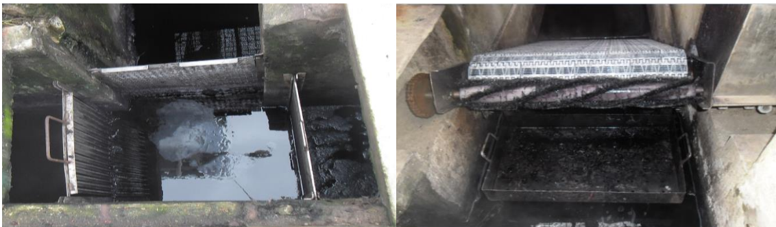
Fotografía 1-1: Rejillas manuales y automáticas
