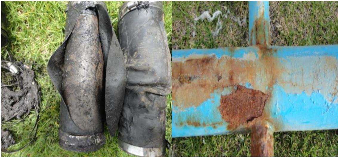
Fotografía 4-1: Membranas y tubería de aireación en mal estado.
