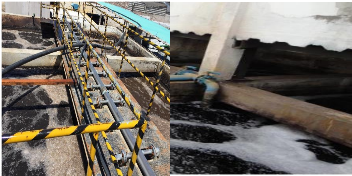
Fotografía 5-1: Sistema de aireación en perfectas condiciones.
