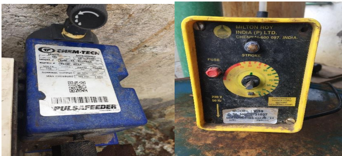
Fotografía 3-1: Bombas dosificadoras en mal estado.
