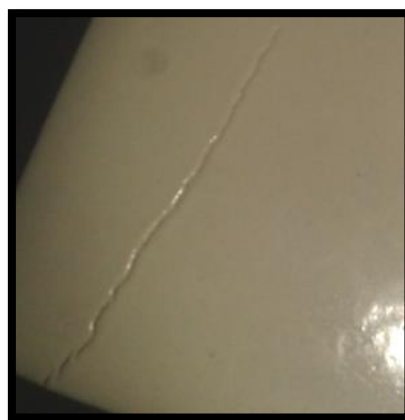
Figura 3-4 Cerámica con fisura
