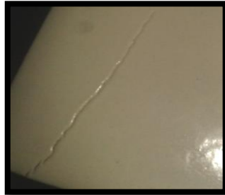
Figura 1-23 Cerámica con fisura
