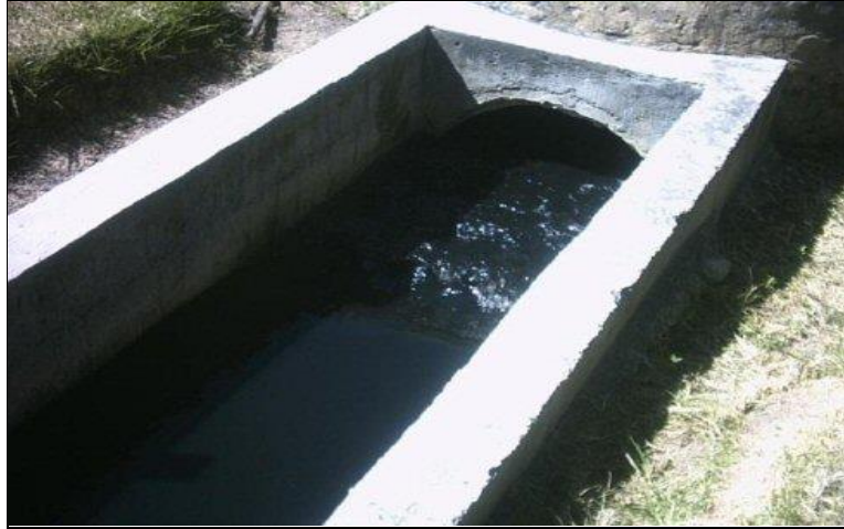
Figura 5-3 Canal de captación hacia el sistema de tratamiento
