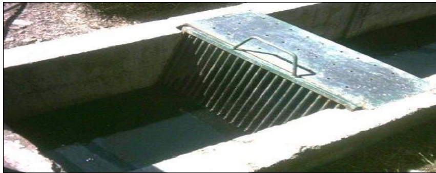
Figura 7-3 Rejillas de limpieza manual y mecánica
