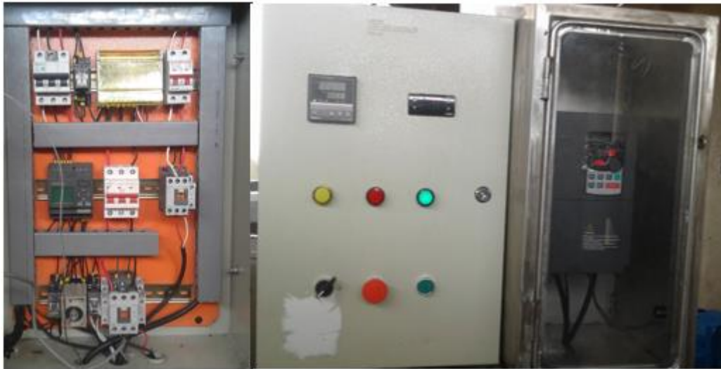
Figura 3-6: Tablero de control
