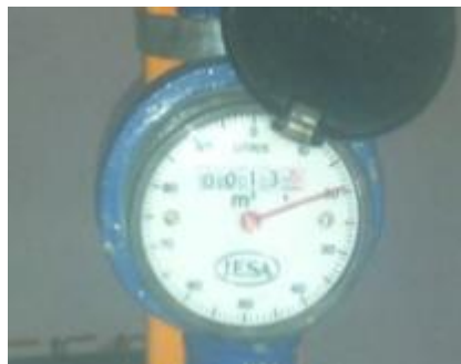
Figura 4-3. Medidor de agua tipo DVM-A
