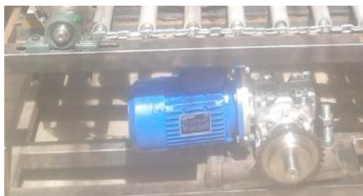
Figura 6-7. Ubicación motor reductor
