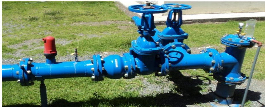
Fotografía 1-3. Válvulas de extracción
