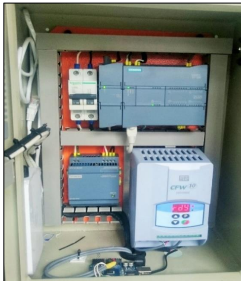
Fotografía 4-4. Tablero de Control
