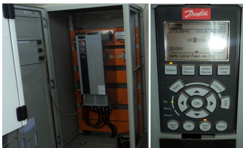
Fotografía 3-3. Tablero de Control
