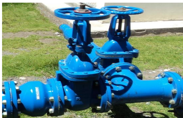
Fotografía 1-4. Válvulas del proceso de captación
