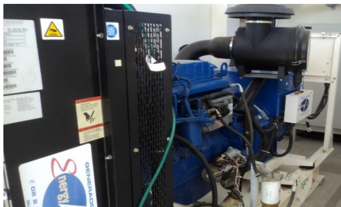
Fotografía 2-3. Generador de energía
