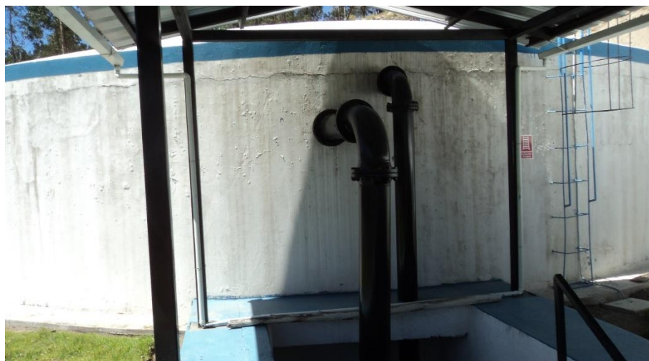
Fotografía 4-3. Tanque de reservorio
