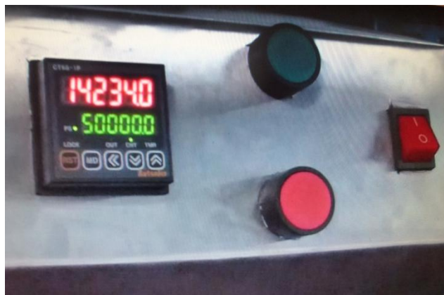
Fotografía 6. Pulsadores de encendido y apagado.
