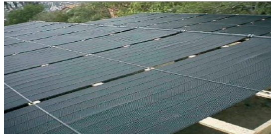
Figura 9-1: Captadores planos sin cubierta Fuente: (Harter Industries, Inc.)
