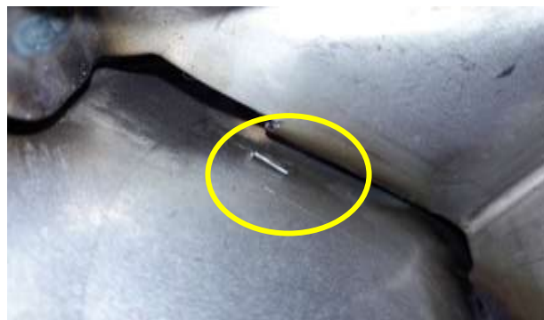
Figura 23. Irregularidad de elemento de suelda
