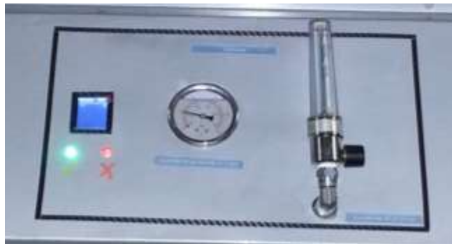
Figura 36. Medidores de flujo en funcionamiento
