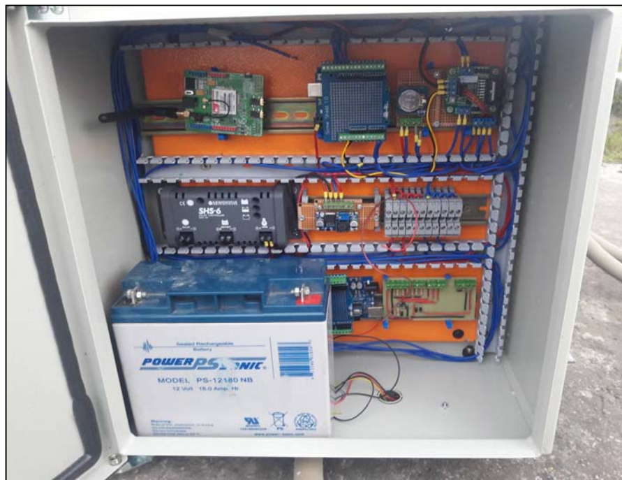
Figura 11-2. Tablero de control instalado
