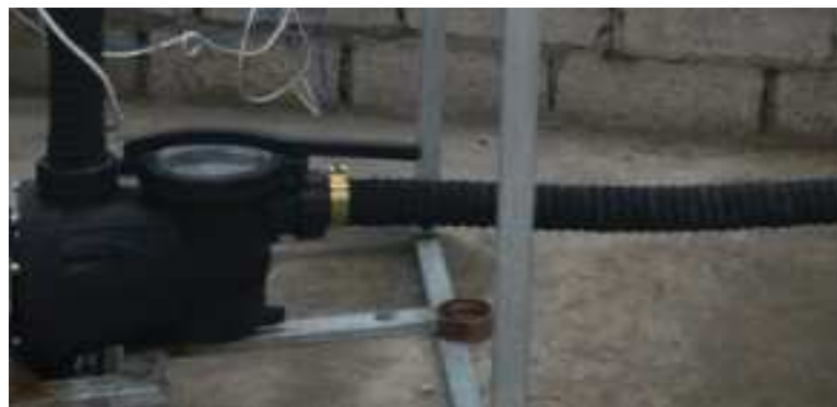
Figura 11-2: Sistema de acople a la entrada Realizado por: Alex Lema & Fabián Padilla, 2017
