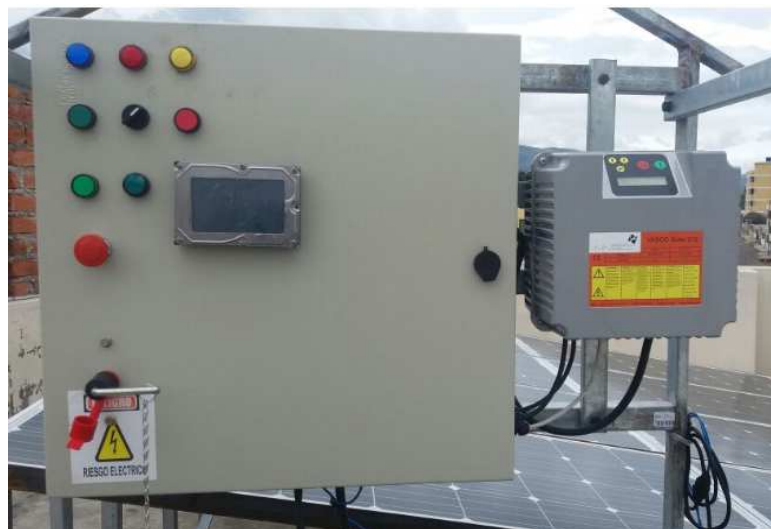
Figura 29-2: Vista exterior del tablero Realizado por: Alex Lema & Fabián Padilla, 2017
