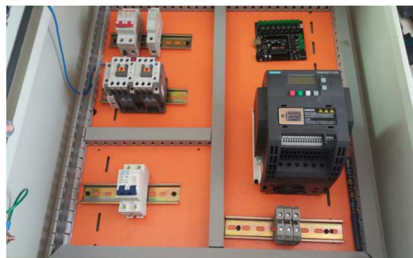
Figura 25-2: Colocación de canaletas y riel DIN Realizado por: Alex Lema & Fabián Padilla, 2017
