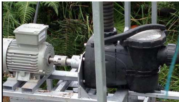
Figura 7-2: Conjunto motor bomba Realizado por: Alex Lema & Fabián Padilla, 2017
