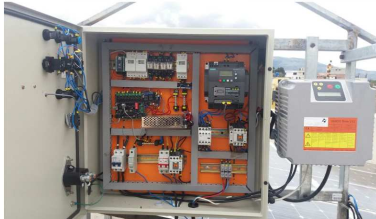
Figura 28-2: Vista interior del tablero Realizado por: Alex Lema & Fabián Padilla, 2017
