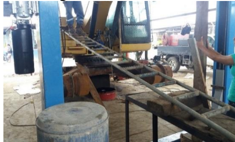
Figura 23. Falta de EPC
