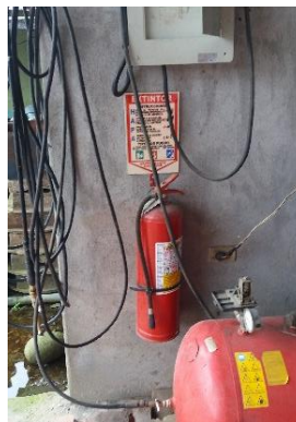
Figura 15. Ubicación incorrecta de extintores
