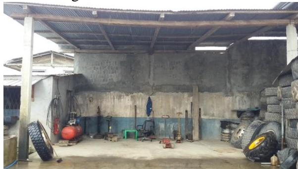
Figura 17. Falta de señalética.
