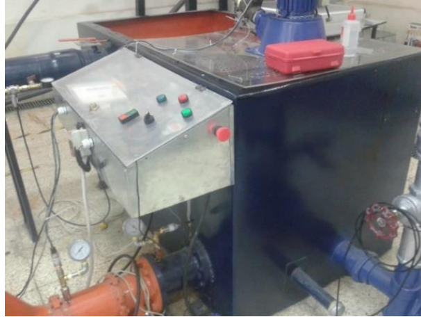
Figura 21. Tablero de control Universal
