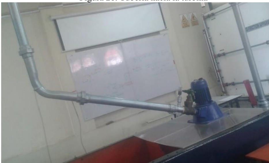
Figura 20. Tubería hacia la turbina
