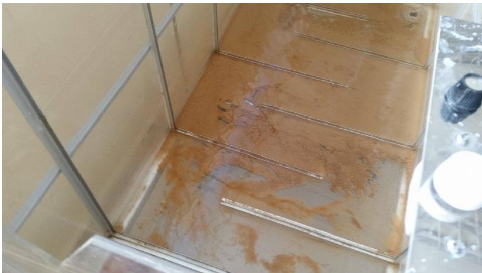
Fotografía 17. Flocs sedimentados en el floculador horizontal
