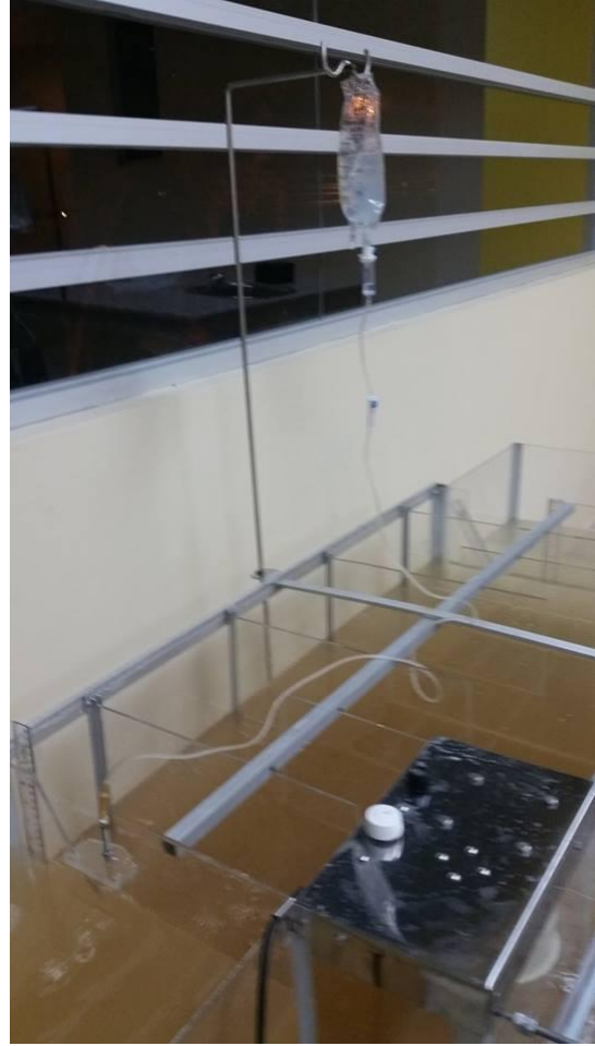
Fotografía 14. Dosificación de reactivos coagulante
