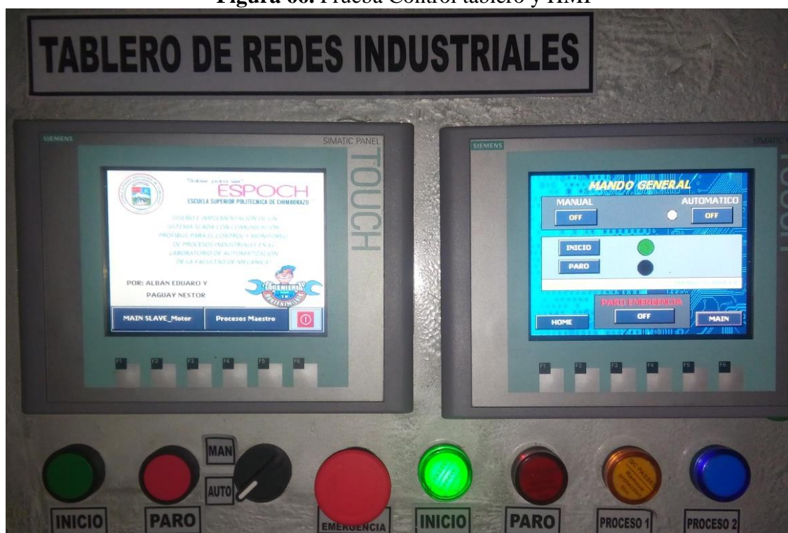
Figura 66. Prueba Control tablero y HMI
