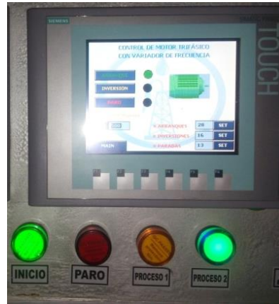
Figura 69. Prueba controles e indicadores del control del motor con variador
