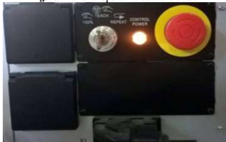
Figura 41. Panel operativo del controlador
