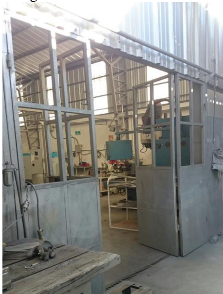
Figura 23. Salida no señalizada
