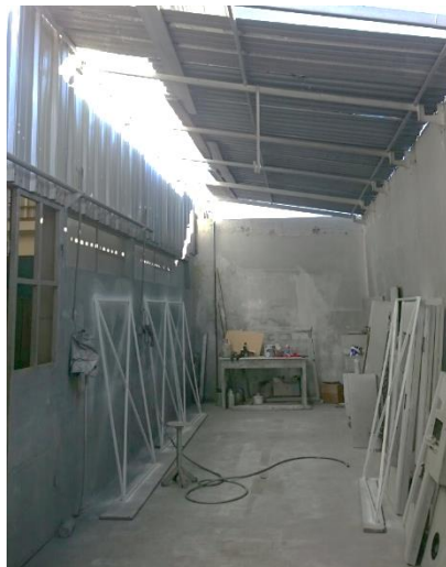
Figura 22. Inexistencia de señalética en el área de pintura
