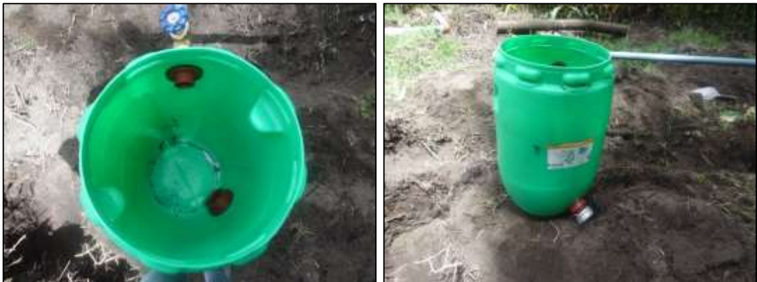
Fotografía 1-2. Tanque de Sedimentación.
