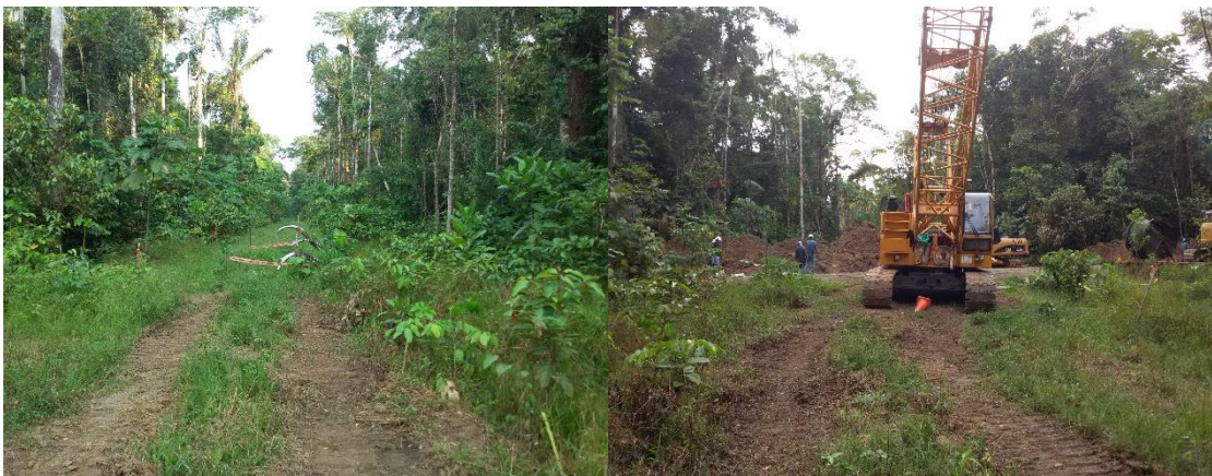
Figura; 2-4 Afectación al momento de identificar una falla Realizado por: TAYUPANTA, William, 2015
