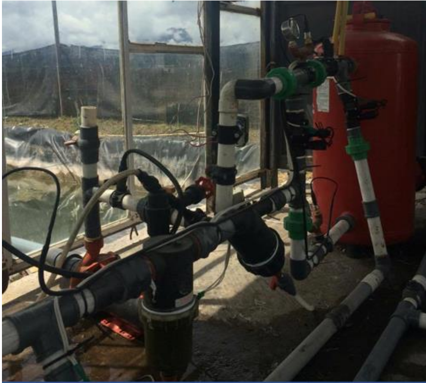
Figura 4-3 Sistema de filtrado
