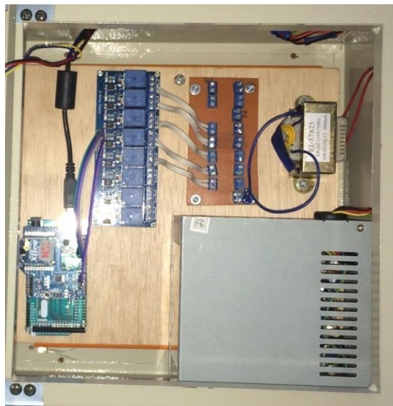
Figura 7-3 Gabinete de Control Parte Interna
