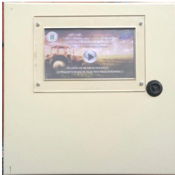
Figura 8-3 Gabinete de Control Parte Externa
