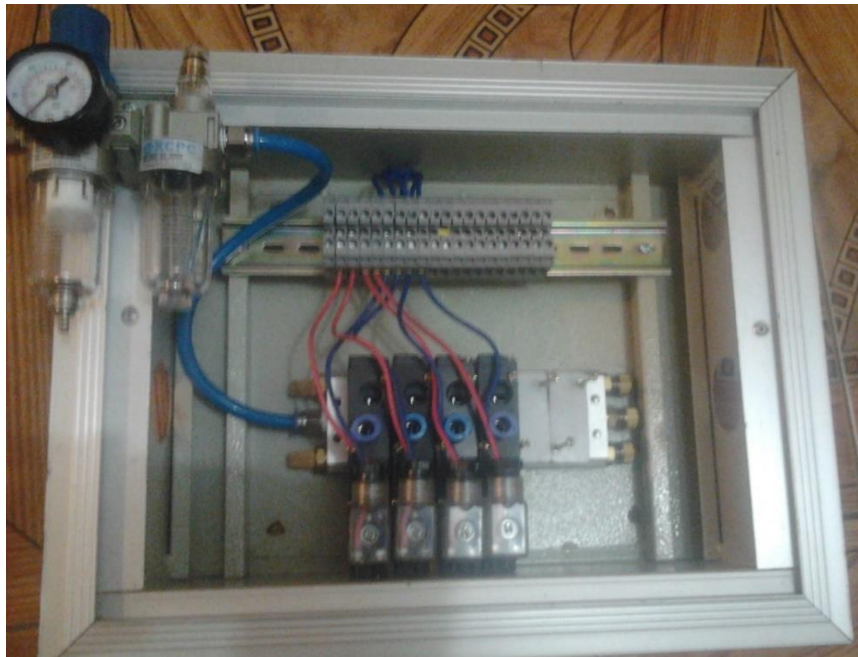
Figura 20-2. Dispositivos instalados en gabinete adicional Fuente: Sánchez, Christian, y Pacheco, Juan, 2016
