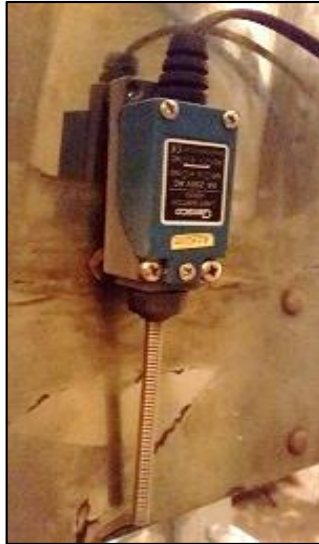
Figura 36-2 Final de carrera de palanca. Realizado por: CALERO, Raúl; CARRILLO, Cristhyan, 2016
