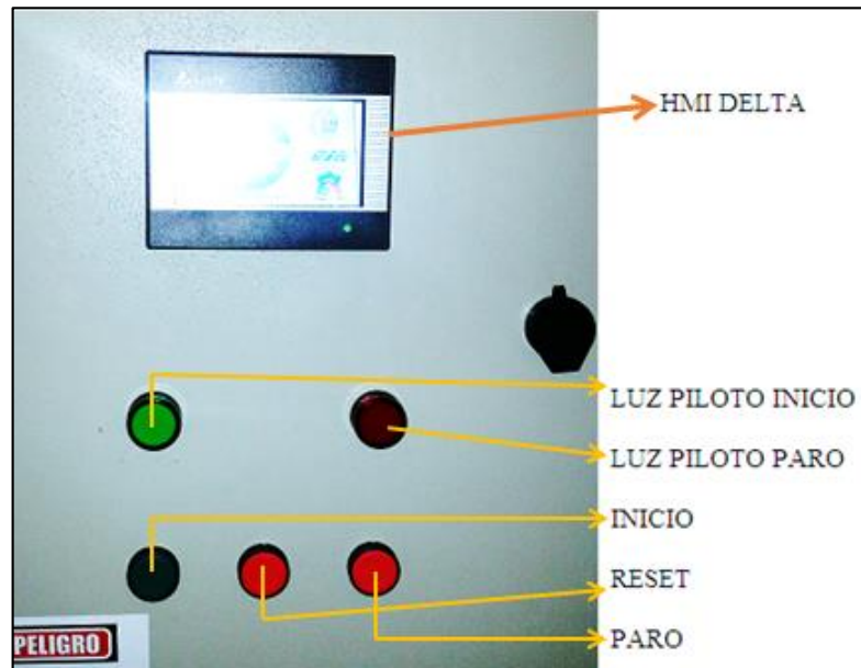
Figura 2-3 Gabinete de control parte externa. Realizado por: CALERO, Raúl; CARRILLO, Cristhyan, 2016
