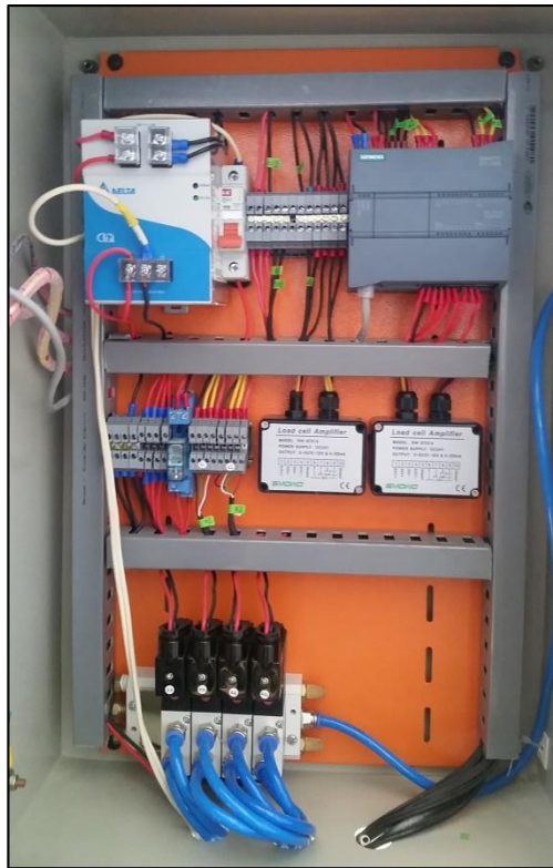
Figura 1-3 Gabinete de control parte interna. Realizado por: CALERO, Raúl; CARRILLO, Cristhyan, 2016
