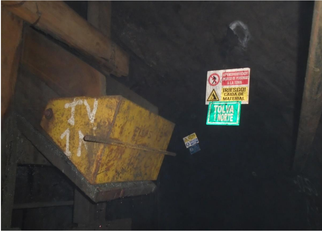
Tolva de descarga.
