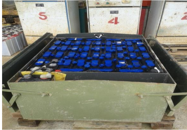
Fotografía 6-2: Banco de baterías. Elaborado por: Ríos Wilmar. (2016)
