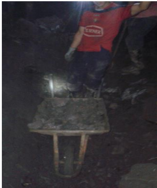
Fotografía 5-2: Acarreo del material en niveles secundarios con carretillas. Elaborado por: Ríos Wilmar. (2016)
