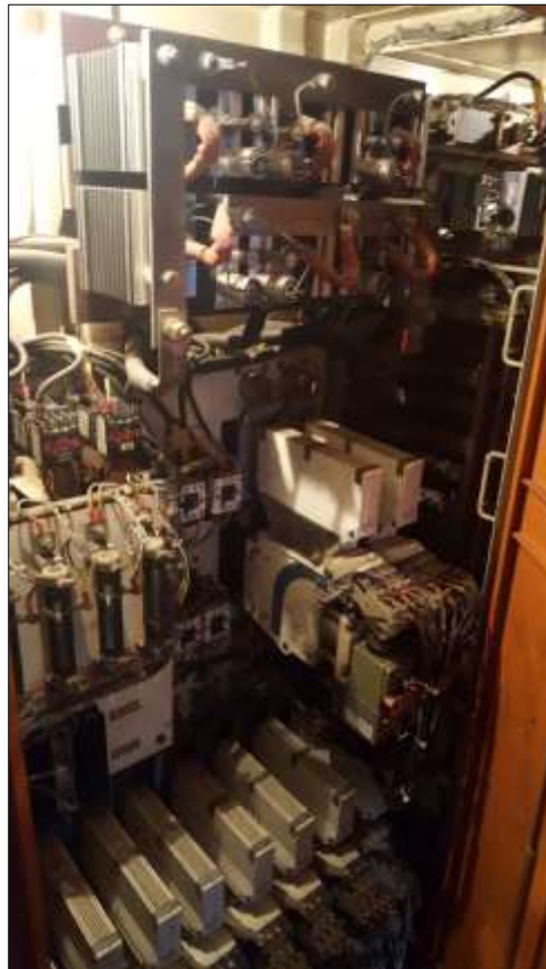
Cableado y componentes eléctricos de control
