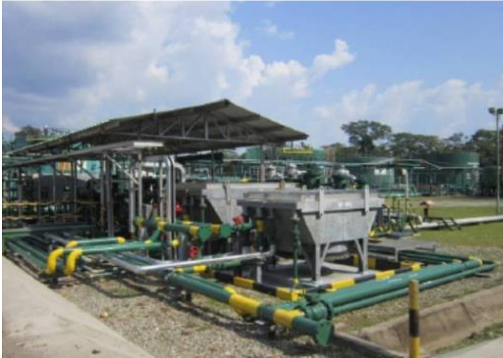
Fuente: Fotografías sistema de compresión de Gas CPF Realizado por: Sánchez D.
