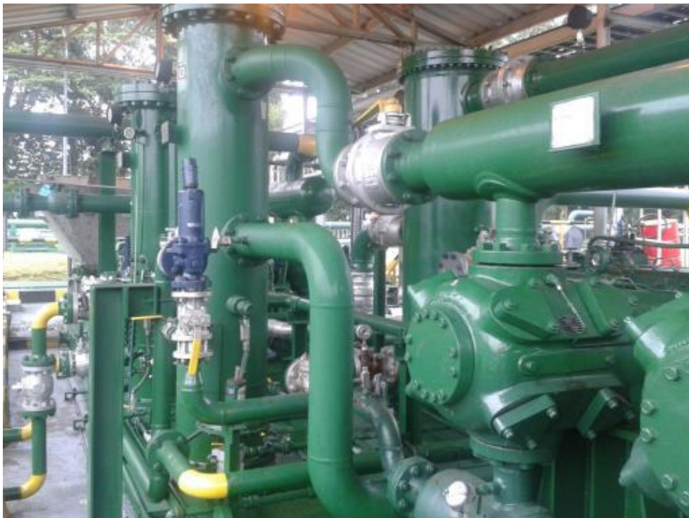
Fuente: Fotografías sistema de compresión de Gas CPF Realizado por: Sánchez D.
