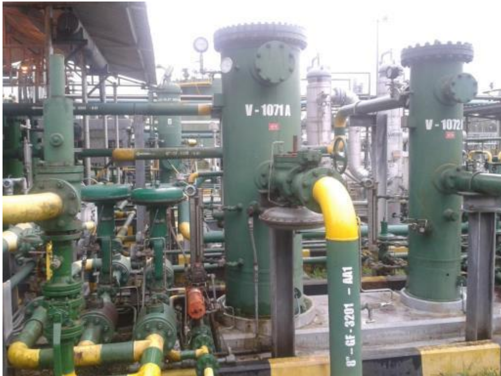
Fuente: Fotografías sistema de compresión de Gas CPF Realizado por: Sánchez D.
