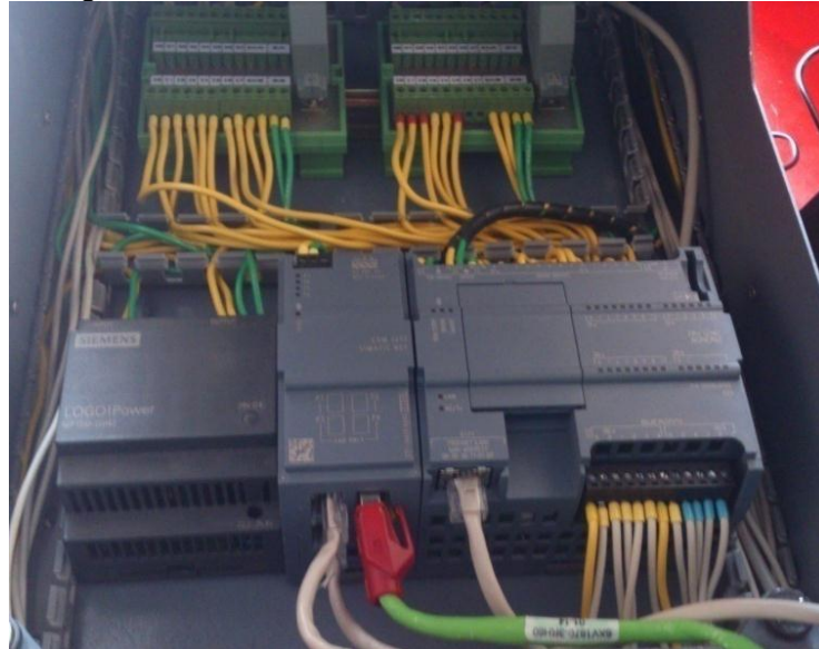
Figura 80. Verificación de las conexiones eléctricas
