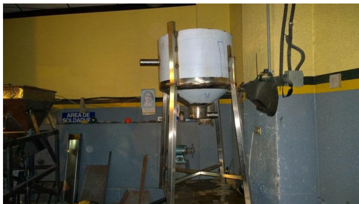
Fotografía 8. Estructura del espesador de lodos por gravedad.
