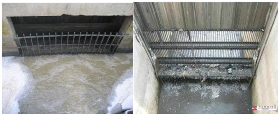
Grafico 1-1: Pretratamiento con rejillas de barra metálicas paralelas
