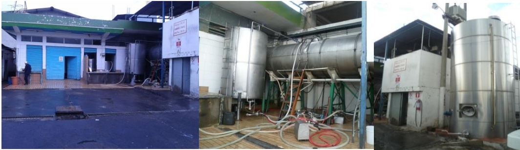
Anexo B. Depósito de recolección de las aguas residuales de las líneas de producción.
