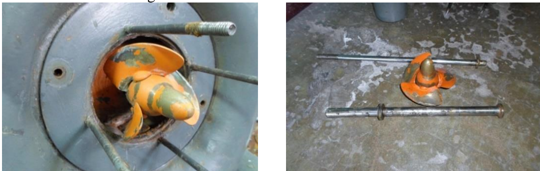
Figura 44. Rodete antes del mantenimiento
