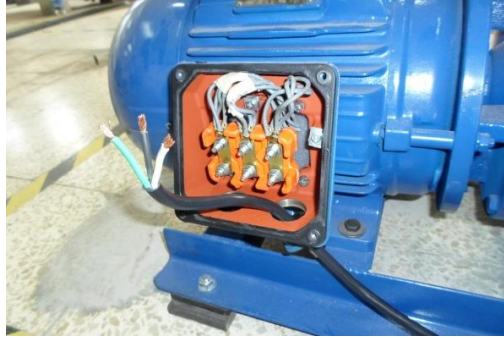
Figura 87. Conexión eléctrica de la bomba
