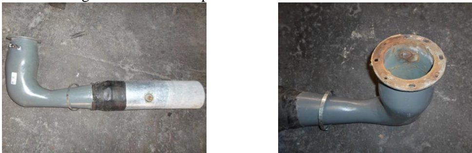
Figura 47. Tubo de aspiración antes del mantenimiento
