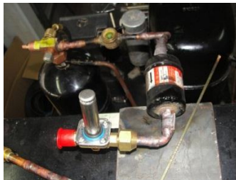
Figura 74. Conexión de válvula solenoide al sistema
