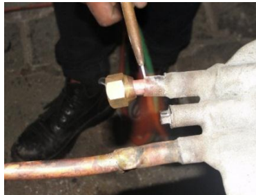
Figura 88. Tuerca de bronce con tubería a entrada de placa eutéctica
