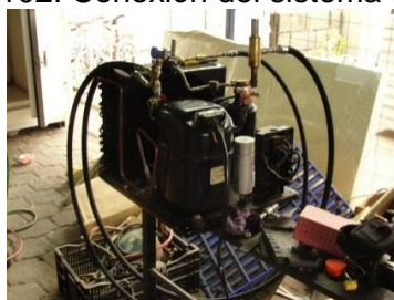
Figura 102. Conexión del sistema eléctrico
