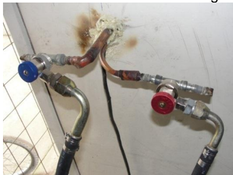
Figura 107. Conexión de sistema de carga frigorífica
