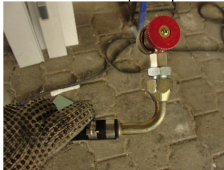
Figura 106. Conexión del sistema de acoples rápidos a mangueras de presión
