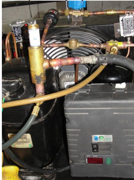
Figura 103. Conexión de presóstatos de baja y alta presión, controlador de temperatura y caja eléctrica
