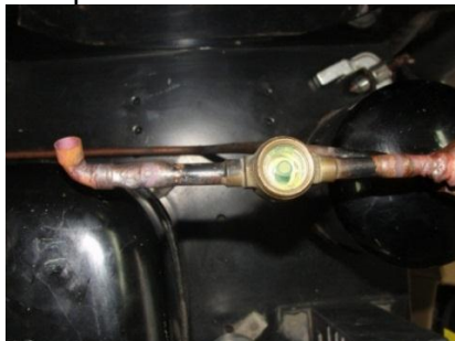
Figura 66. Visor de líquido conectado en secuencia con la tubería
