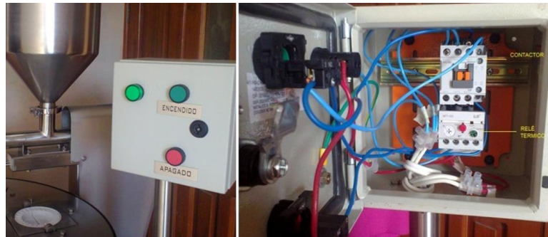
Figura 124. Caja de control y sus elementos
