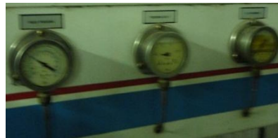
Figura 19. Manómetro de alta y baja presión
