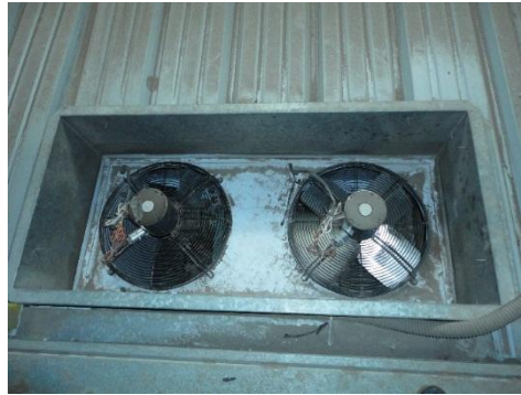
Figura 35. Ventiladores del evaporador
