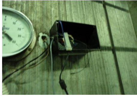
Figura 51. Instalación de la tarjeta Arduino
