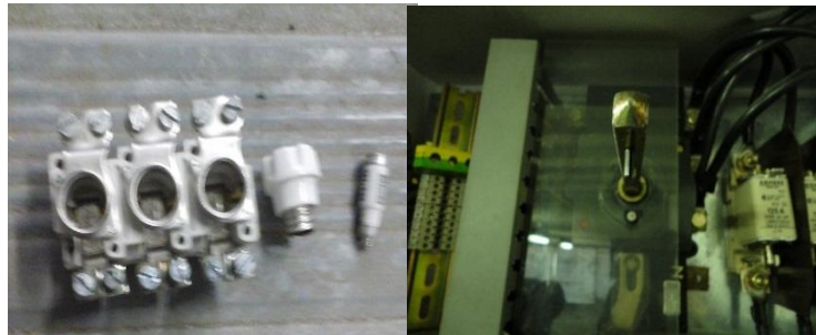
Figura 29. Fusibles y palanca de energización
