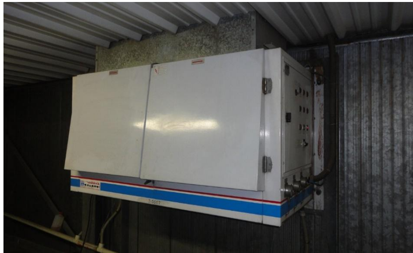
Figura 24. Cámara de refrigeración
