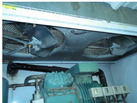
Figura 36. Ventiladores del condensador
