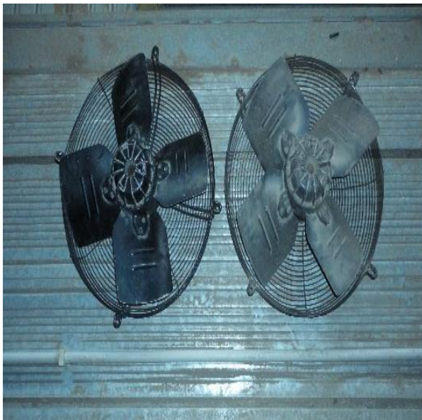
Figura 39. Ventiladores antiguos, aspas y motor
