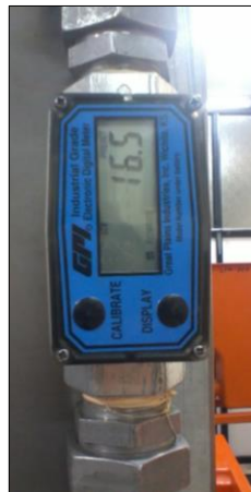
Figura 56. Caudalímetro en funcionamiento
