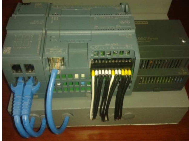
Figura 42. Conexión del compact switch y el PLC
