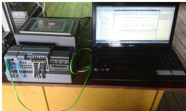
Figura 63. Conexión entre el módulo automático y PC
