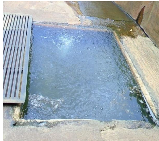
Fotografía 2-2. Punto donde emerge el agua en la piscina
