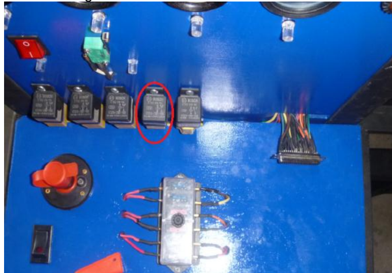
Figura 59. Relevador electro ventilador
