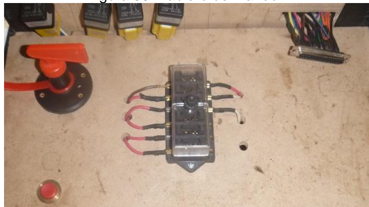
Figura 36. Tablero de mando 2
