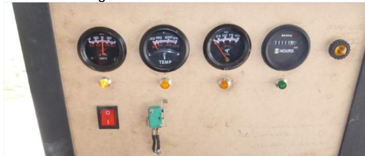
Figura 35. Tablero de mando 1
