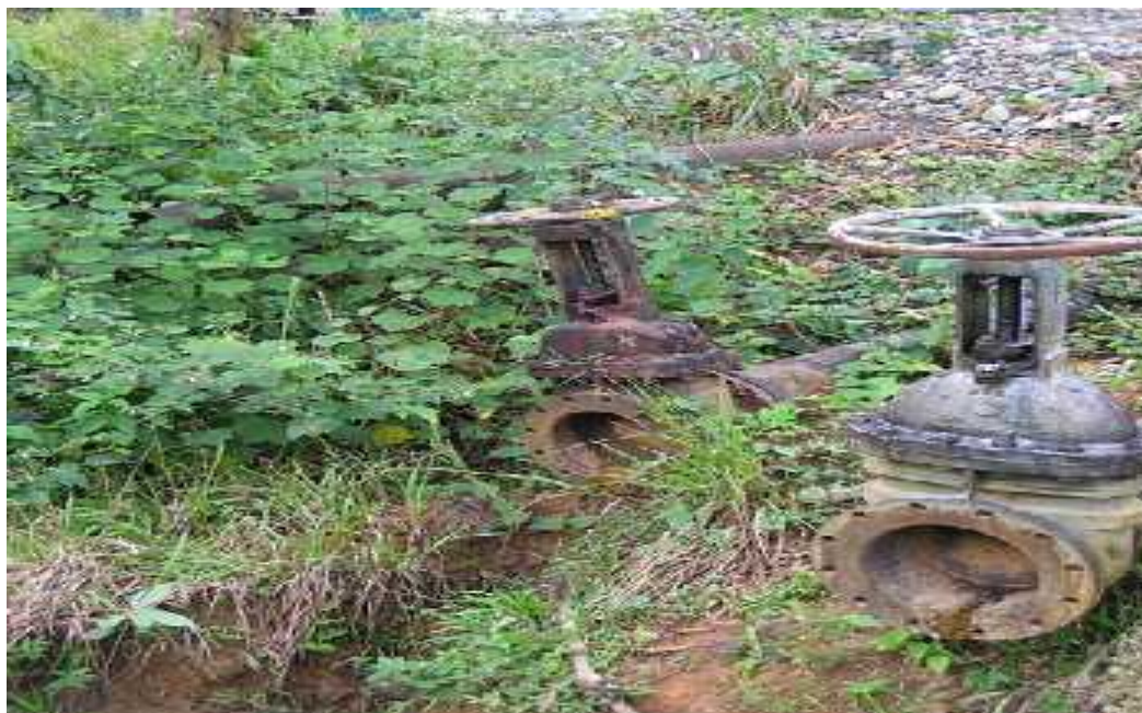
Figura N° 10. Válvulas que drenan al ambiente el agua de reinyección en la estación Atacapi
