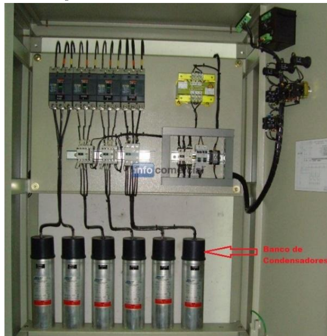
Figura 40. Banco de condensadores
