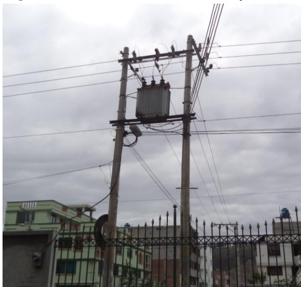
Figura 18. Transformador trifásico pozo Uno
