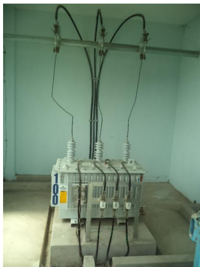
Figura 19. Transformador trifásico del pozo Dos
