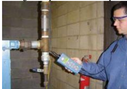
Figura 7. Detección de fugas de presión o vacío por medio del ultrasonido
