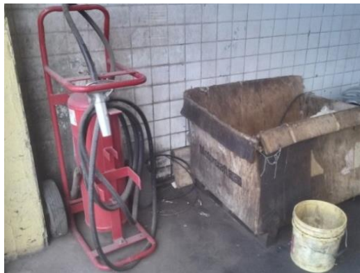
Figura 17. Extintores en mal estado
