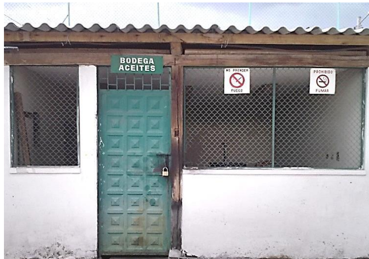
Figura 28. Señalización inadecuada en la bodega de aceites
