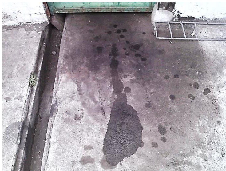
Figura 29. Derrame de aceite en el piso de la bodega de aceites
