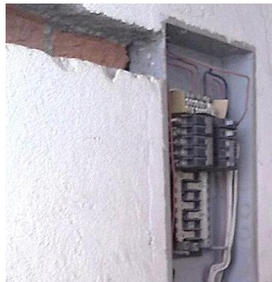
Figura 31. Instalaciones eléctricas defectuosas de la bodega de aceites
