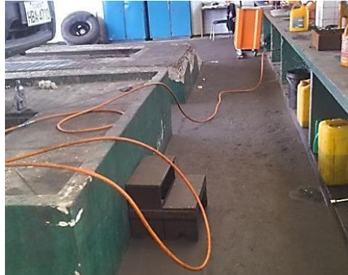
Figura 19. Cableado neumático desordenado
