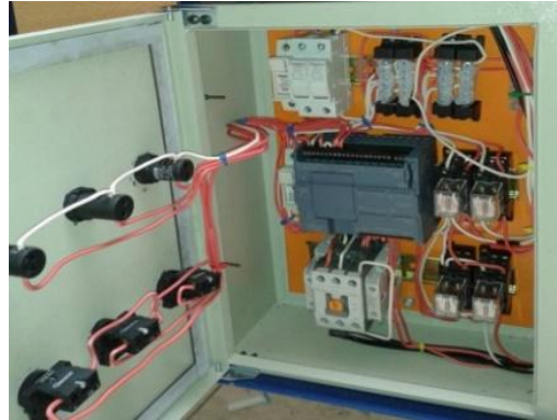
Figura 35. Caja de control
