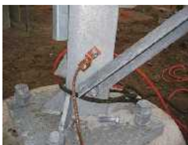
Figura 33. Torre con un cable de cobre grueso conectado a tierra 27
