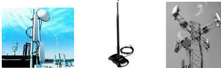
Figura 28. Antenas direccionales, omnidireccionales y sectoriales 23
